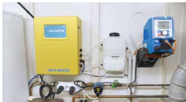
Zentral implementiert versorgt SAFEWATER sämtliche Entnahmestellen der Trinkwasserinstallation der Praxis.
