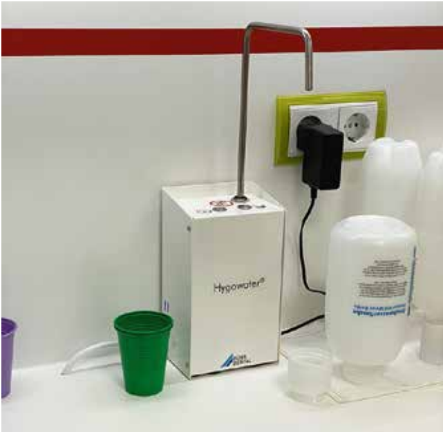
Installation des Wasseraufbereitungssystems Hygowater Compact mit „Filling Station“ in der Praxis halloZAHN, Rielasingen-Worblingen: geringerer Aufwand, sichere Unterschreitung der gesetzlichen Obergrenze von 100 KBE/ml. Fotos: Dangel/Dürr
